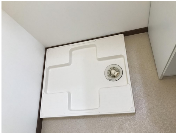
7.洗濯機防水パン
